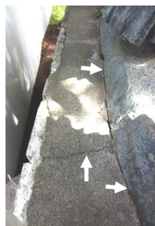
台座のひび割れ
