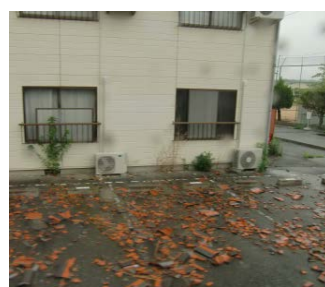
震災で落ちたままの屋根瓦
